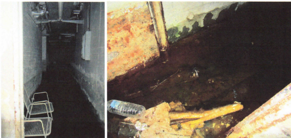
Abb.: Flur nach links im Haus Abb.: Unrat im Wasser vom Kellergeschoss
